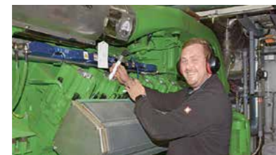
Tim Koßek am modernen Blockheizkraftwerk.
